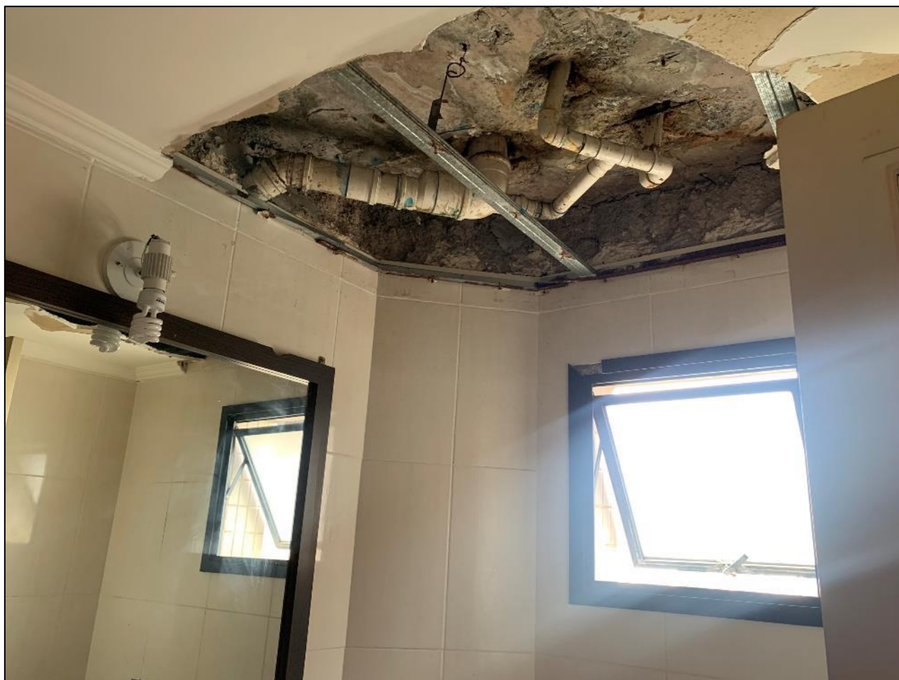
FOTOGRAFIA 45: Detalhe dos danos causados ao forro de gesso.
